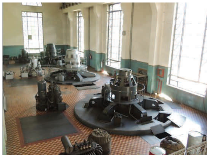
Pohled do strojovny VE, soustrojí TG3 je v popředí
